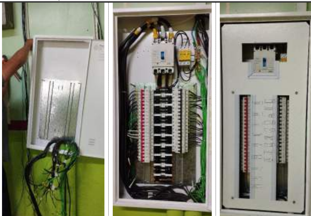
Imagens 10, 11 e 12 – Instalação Novo QDF - AC 02 – Quadro de Distribuição e Força Ar Condicionado. (Local Próximo ao DAP).
