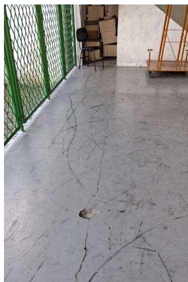
Fotografia 7 – Vista de alguns pontos dentro da Quadra Poliesportiva do IFAM CMDI, onde devem ser realizadas correções no piso. Imagem registrada no dia 06 de junho de 2025.
