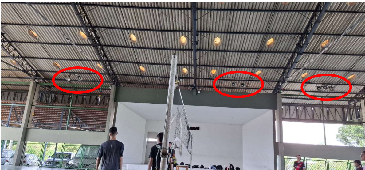
Fotografia 4 – Vista das luminárias laterais da Quadra Poliesportiva. Detalhe para os refletores não possuem proteção blindada para as lâmpadas, causando a quebra destas por boladas provenientes das atividades esportivas. As luminárias devem ser providas de tela protetiva para minimizar os danos aos equipamentos.
