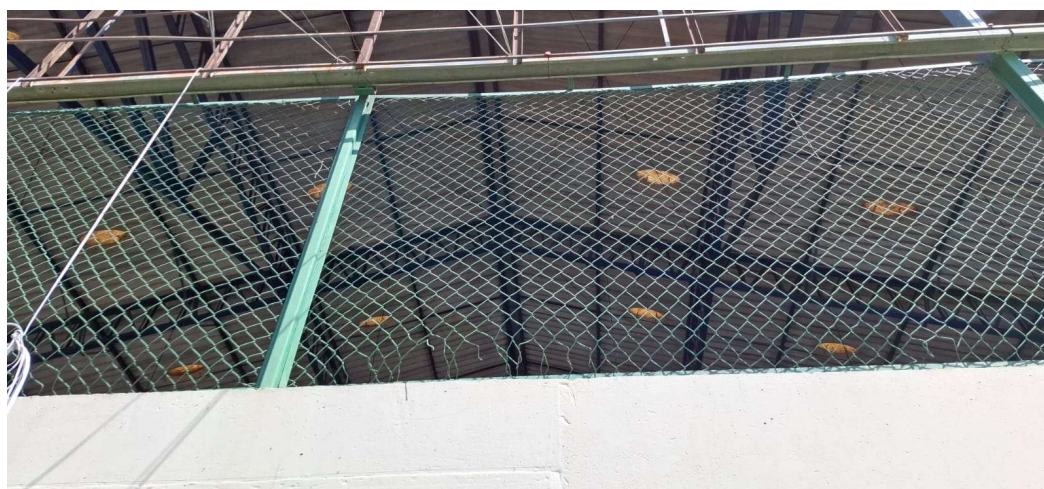
Fotografia 8 – Algumas telas externas de proteção necessitam de revisão para adequado funcionamento. Imagem registrada no dia 06 de junho de 2025.
