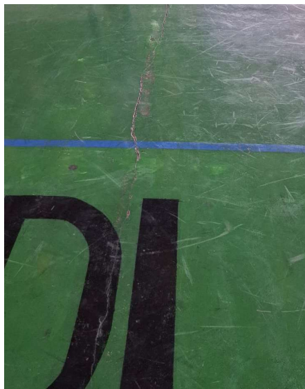
Fotografia 1 – Vista do piso da Quadra Poliesportiva do IFAM Campus Manaus Distrito Industrial. Detalhe para fissuras no piso causado por variações térmicas no concreto. Imagem registrada no dia 06 de junho de 2025.
